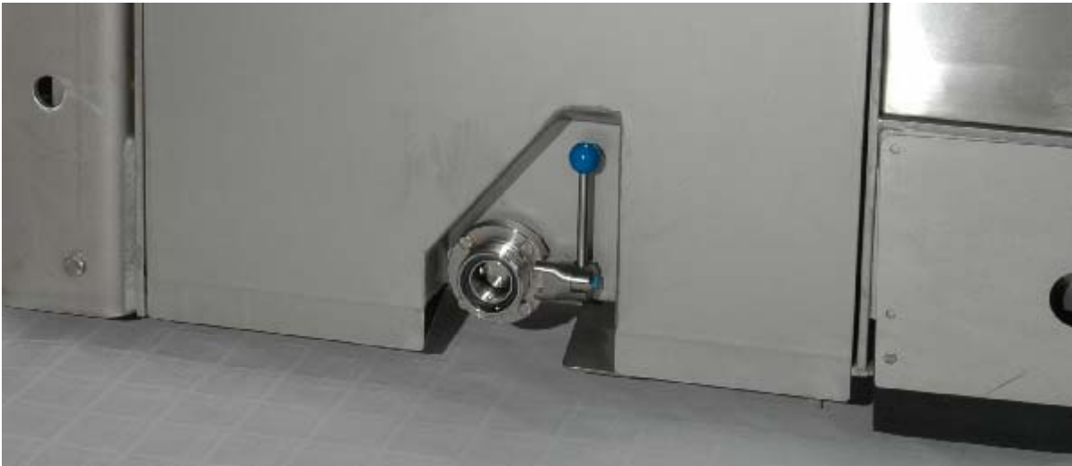
Abbildung 15 Beispiel eines eingebauten Scheibenventils in einem Behälter als Grundablass
